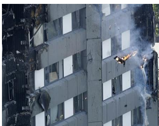
Duidelijk te zien hoe de panelen kunnen branden en zo het vuur zich snel heeft kunnen verspreiden
